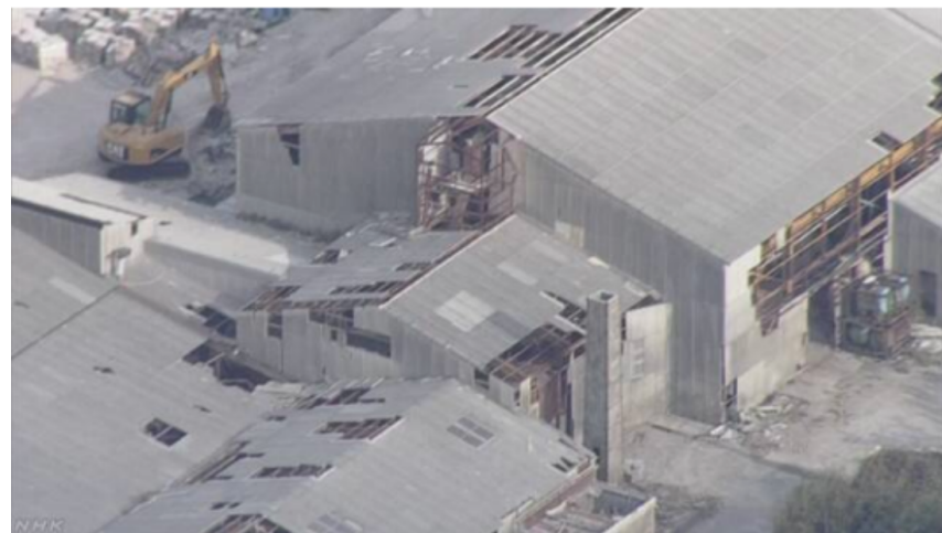
2019年台風15号での被害(伊豆大島)
